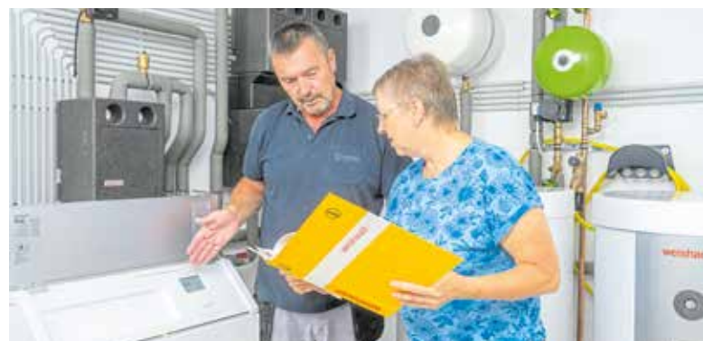
Welche neue Heizung ist die richtige? Eine Übersicht über die kommunalen Wärmepläne hilft auch bei der Beratung. Foto: ZVSHK
